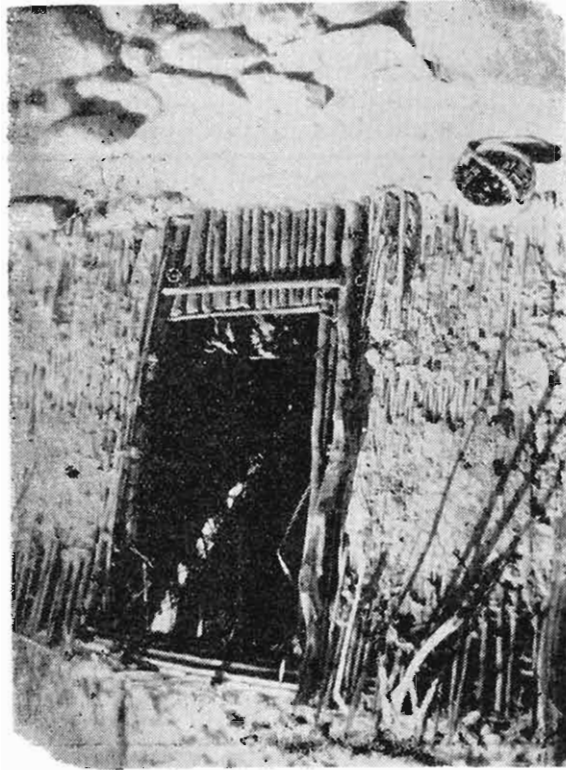
Fig. N° 5.— Detalle de una pared de vivienda pobre, hecho de carrizo, mal revocado y sitio preferente de refugio de los reduvídeos.
