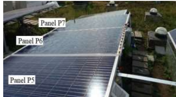
Figura 5. Paneles FV en estado de irrigación. Fuente. Elaboración propia.
