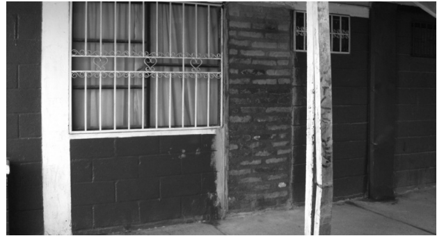
Imagen 12: Acceso clausurado por patio común Caso 3
