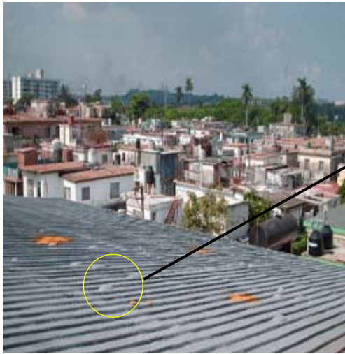
Figura 11. Ampollas sobre cubierta metálica. Obra: Poligráfica Federico Engels. Fotos de las autoras.
