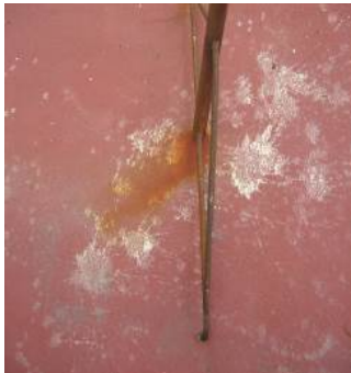
Figura 6. Mancha de óxido de hierro. Obra: Escuela Nacional de Ballet. Fotos de las autoras.
