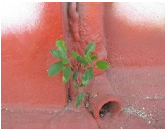
Figura 15. Vegetación por acumulación de sedimentos fértiles y humedad en la cubierta. Obra: Escuela Nacional de Ballet. Foto de las autoras.
