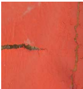
Figura 8. Grietas en una cubierta prefabricada. Obra: Hospital Hermanos Ameijeiras Foto de las autoras.
