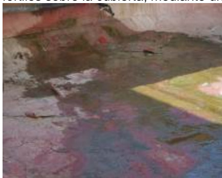
Figura 4. Agua estancada sobre la cubierta. Obra: Hospital Hermanos Amejeiras. Foto de las autoras.
