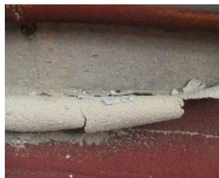
Figura 9.1. Desprendimiento del revoque junto con el sistema impermeable.
