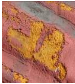
Figura 7.1 Deterioro del sistema impermeable en la zona de la cresta de la teja acanalada de asbesto cemento
