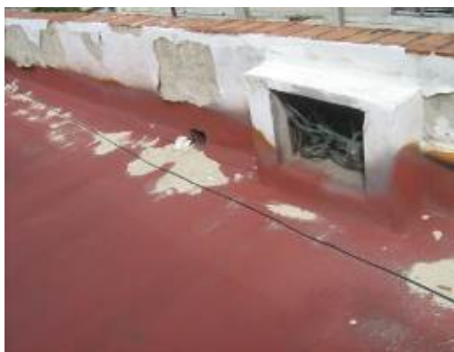
Figura 9. Desprendimientos del revoque en el pretil. Obra: Obra Escuela Nacional de Ballet Fotos de las autoras.
