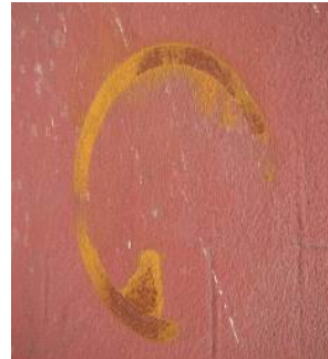
Figura 6.1 Manchas de óxido producido por la base de un objeto de hierro colocado sobre la cubierta. Obra Escuela Nacional de Ballet.
