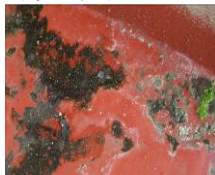
Figura 4.1. Detalle de crecimiento vegetal sobre la membrana protectora del sistema impermeable.
