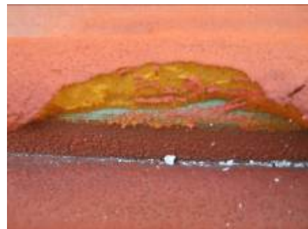
Figura 14.1 Desprendimiento del sistema donde se localizaba la grieta de media luna.
