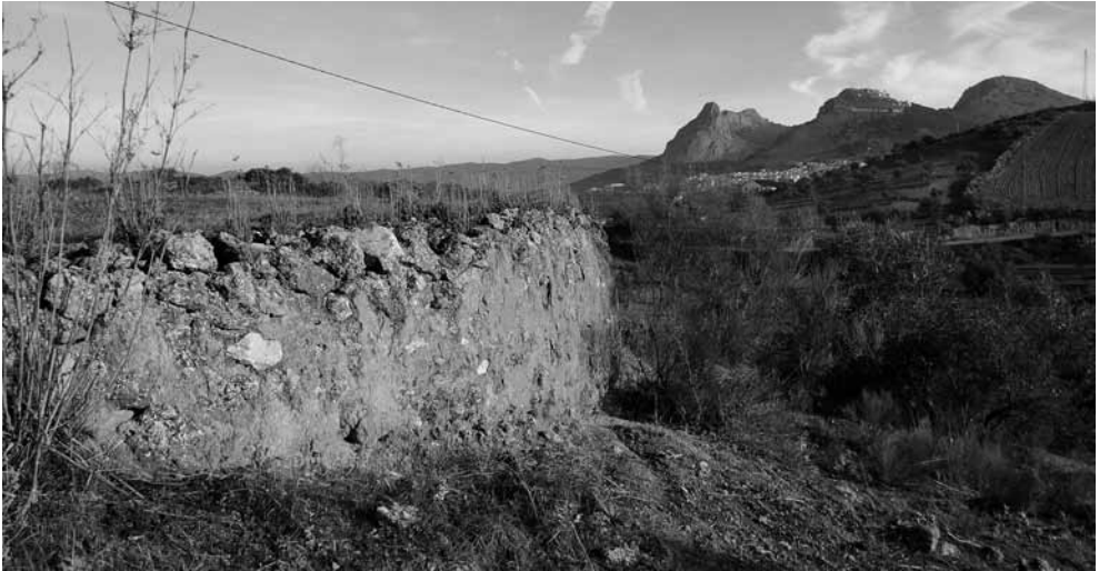
Era circular con un diámetro entre los 14,70 y 17,70 m. Muro de contención de 1,50 a 2,10 m.
