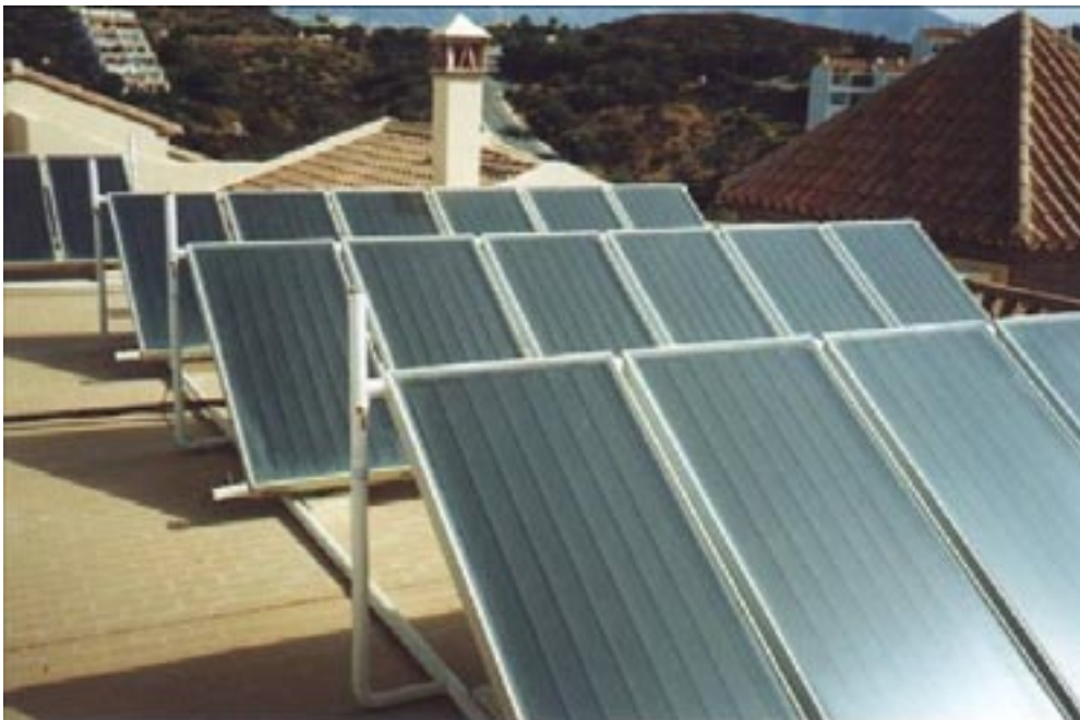
Fig. 6. Instalación solar térmica de agua caliente sanitaria en un bloque de viviendas
