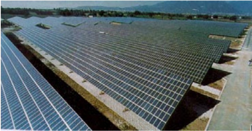
Fig. 8. Central fotovoltaica conectada a la red convencional
