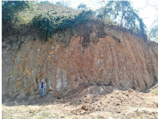
Figura 17. Patrones de diaclasamiento y falla rumbo deslizantes, sobre el talud localizado sobre la vía San Francisco de Asís-Puente Quemao
