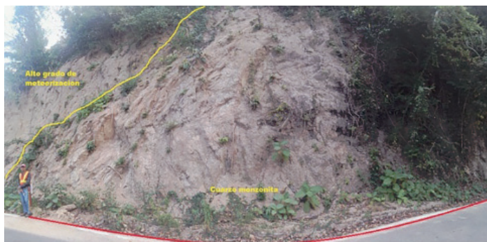
Figura 6. Al margen izquierdo se muestra la roca con un grado de meteorización superior al margen izquierdo, Afloramiento ubicado sobre la vía San Francisco de Asís-Puente Quemao Fuente: Elaboración de los autores
