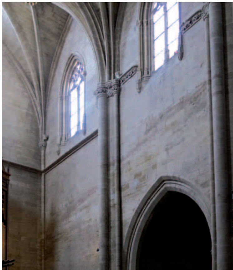
Muro occidental del brazo sur del crucero. La diagonal que baja de derecha a izquierda es la huella dejada por el tejado provisional. (Foto: M. a Celia Fontana Calvo)
