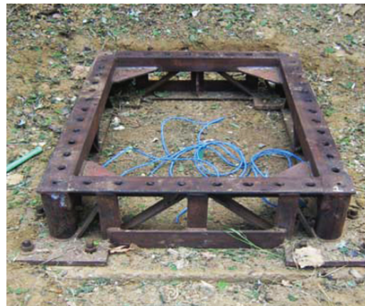
A. Estructura para soporte de paneles.
