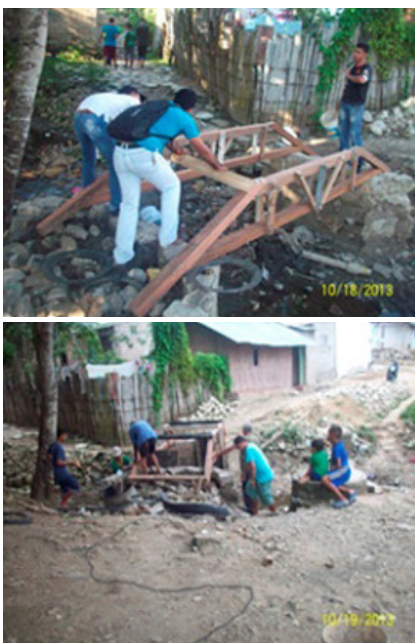
Figura 6: Proceso constructivo con la comunidad. Fuente: El autor, 2013.
