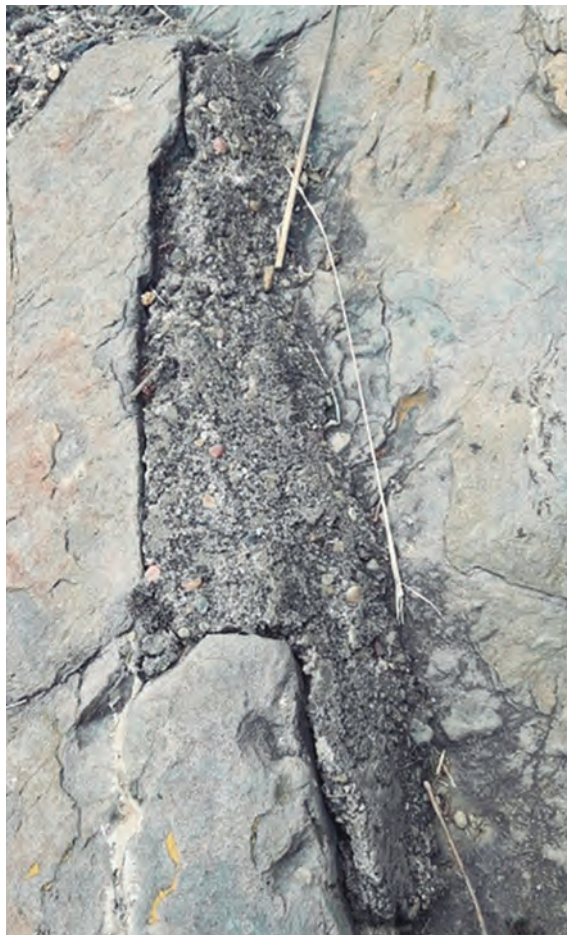
Figura 7. Ejemplo de mortero de cemento en el yacimiento de La Virgen del Campo. La retirada de estos bloques de material supone un riesgo para la integridad del yacimiento.
