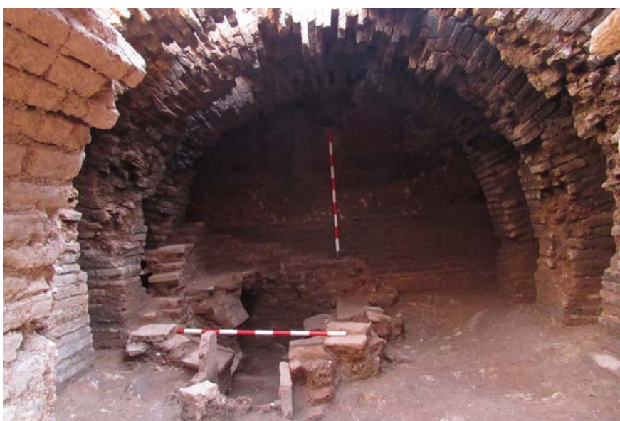
Imágenes: horno de fabricación de latericio. Podemos observar en la segunda de ellas un segundo horno fabricado en la cámara de combustión del primero una vez abandonado su uso.
