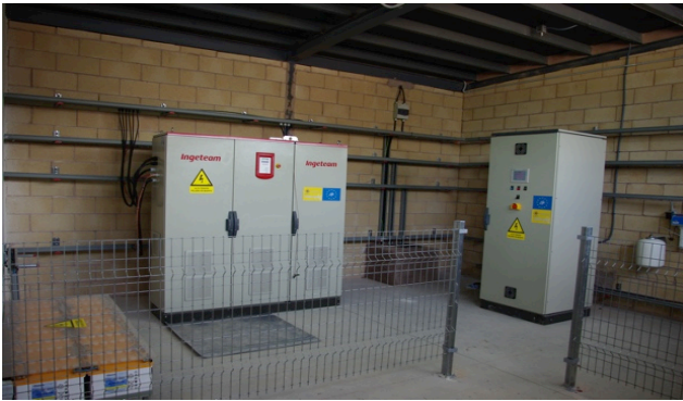
Figura 13. Inversor y controlador del electrolizador.
