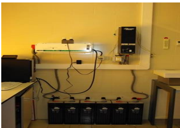
Figura 4. Acondicionador de potencia y baterías.
