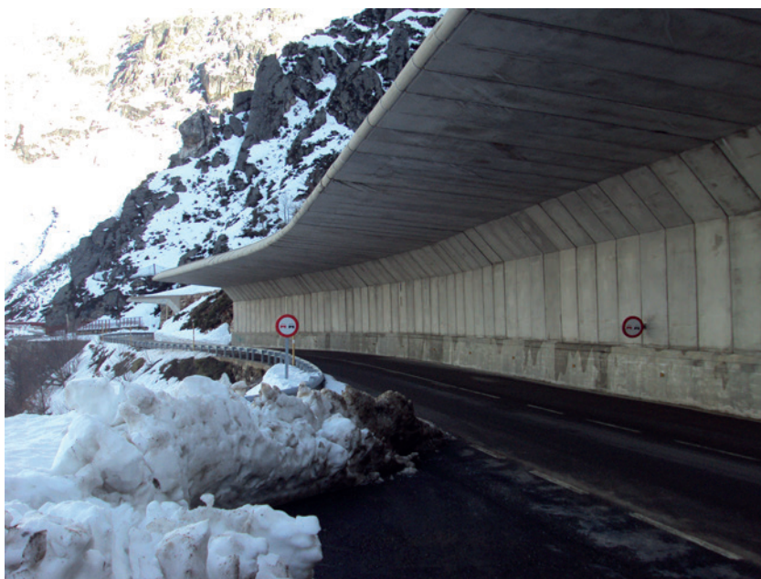
Imagen 9. En primer término las viseras anti-aludes instaladas, y al fondo las mallas metálicas elásticas. Ambas son medidas pasivas que buscan desviar/contener la nieve.
