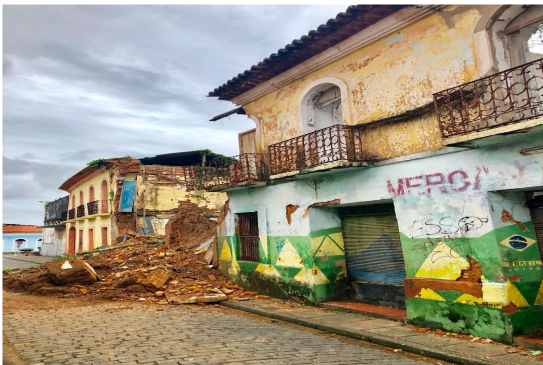
Figura 4: Casarão desmoronado na rua Jacinto Maia, Centro Histórico de São Luís.
