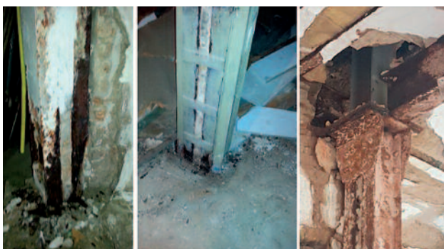
(Figura 21) Estado de pilares y rehabilitación.
