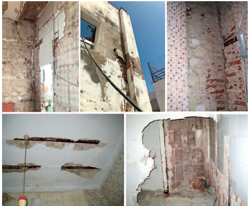
(Figura 14) Daños en forjados y medianeras.
