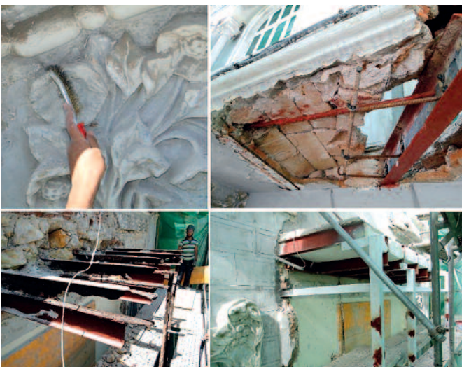
(Figura 4) Patologías y refuerzos.
