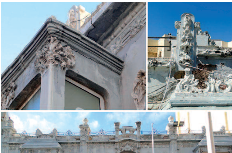
(Figura 3) Detalles patologías en fachada.
