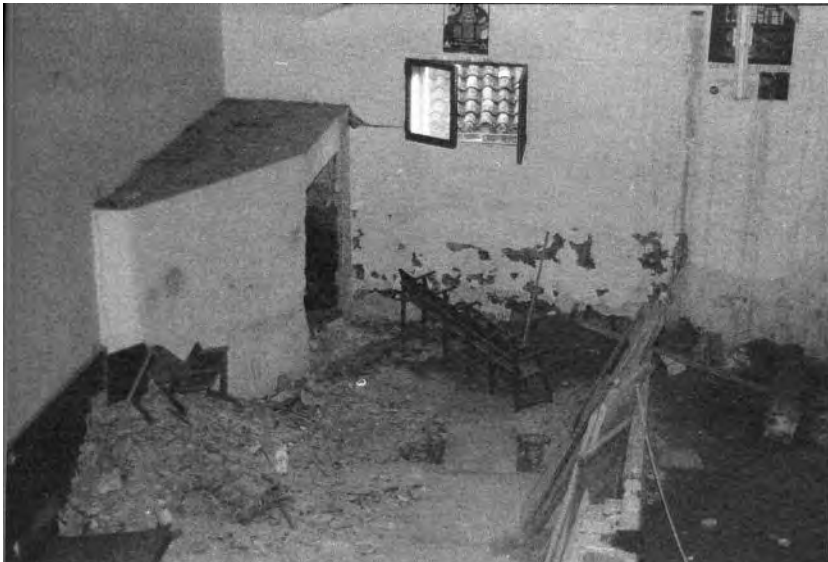
Dues fotografies de l'estat en el qual es trobava el local del Sindicat Agrícola abans de les obres de rehabilitació.
