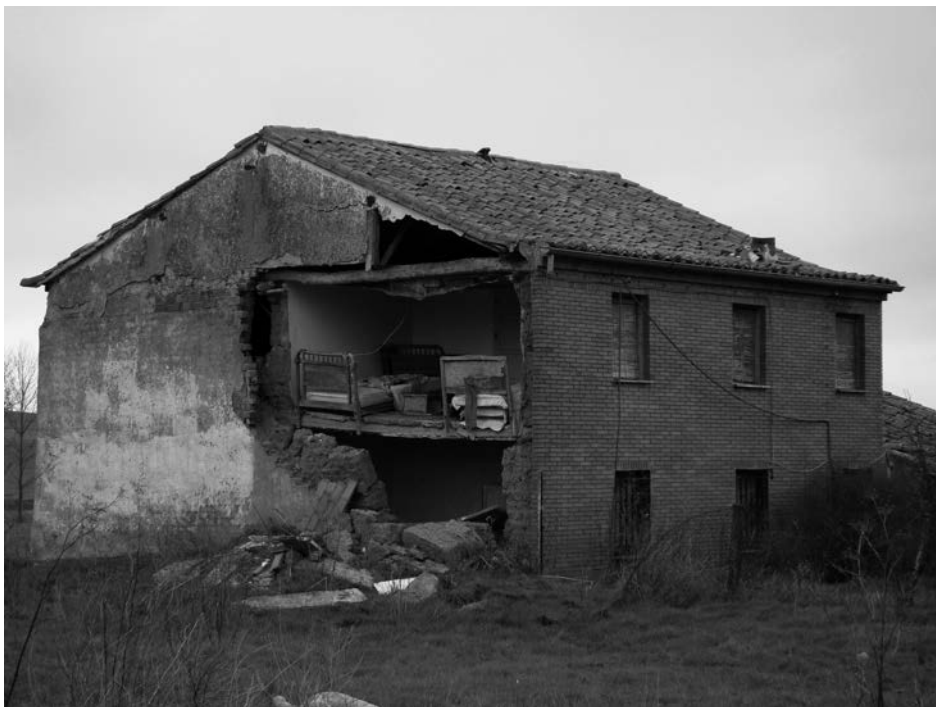
Cardeñosa de Volpejera. Casa en ruinas. Foto E. Delgado. 2013.
