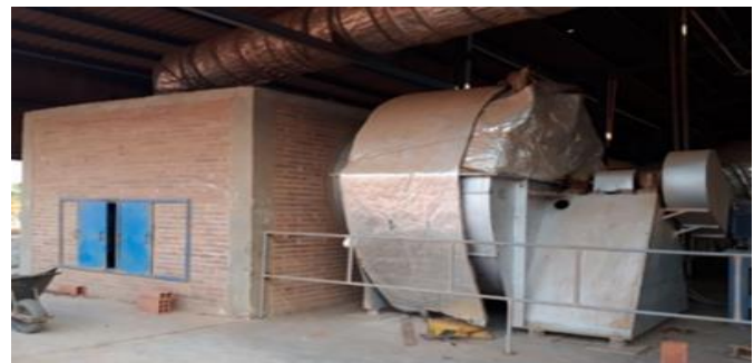
Fig. 6. Ventilador de tiro mixto del secadero en la planta Gres Caribe S.A.
