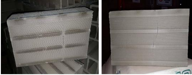
Fig. 12. Bloques con alto contenido de arena.
