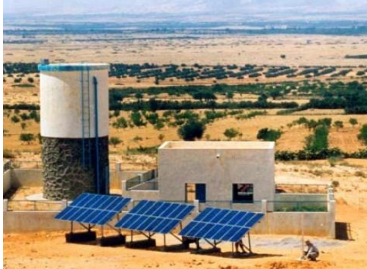
Sistema fotovoltaico de electrificación y bombeo de agua, Túnez 5
