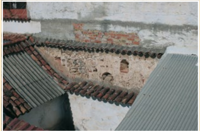
Imagen obtenida desde la terraza del restaurante Casa Eladio, en la que se puede ver en un roto del enfoscado la mampostería irregular que formaba ese tramo de muro.
