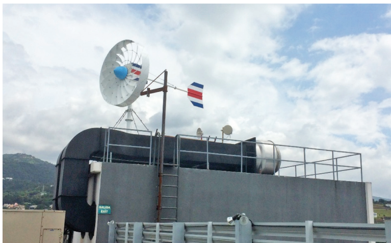
Figura 6. Turbina SkyTwister instalada en el Hotel Sheraton, cortesía de [46].
