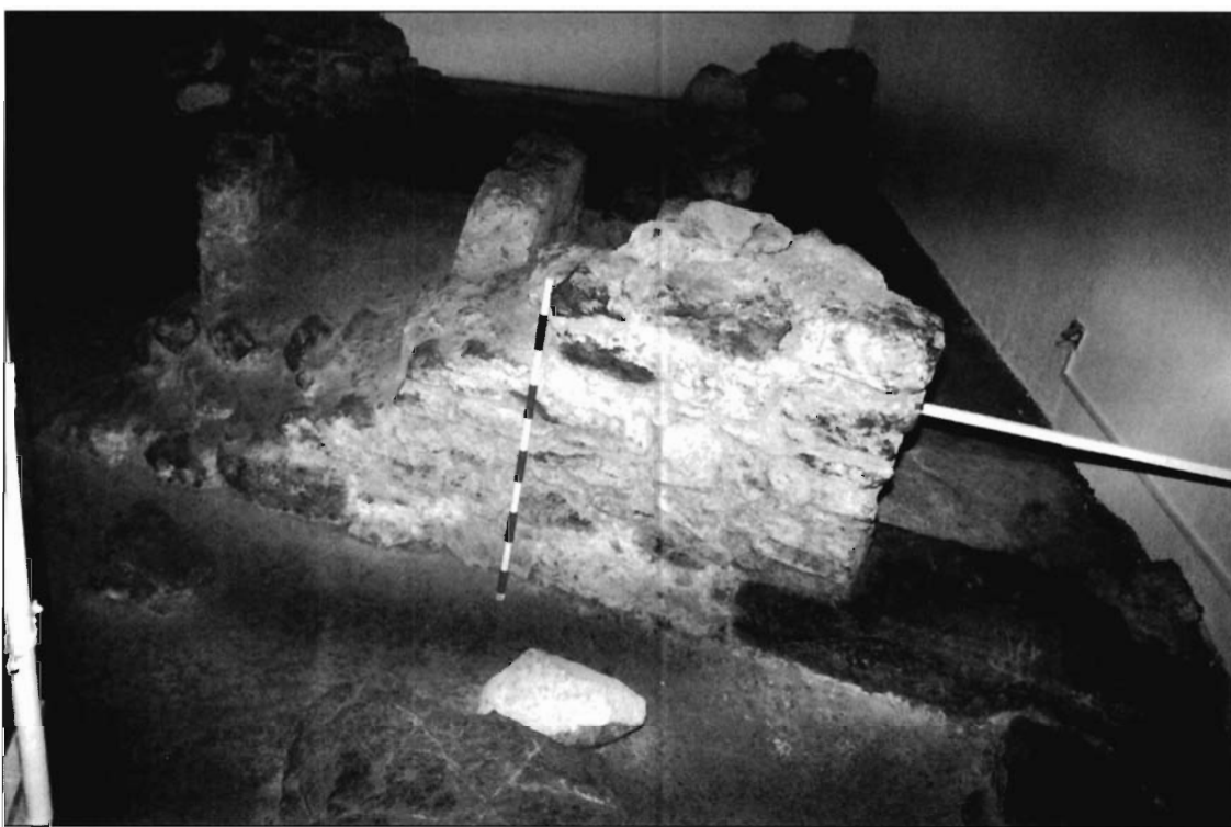
LÁMINA 7. Muro de fachada correspondiente a la taberna ubicada en la Insula B. A la izquierda de la figura se observa la estructura perteneciente a la pileta localizada en la habitación 3 del edificio.
