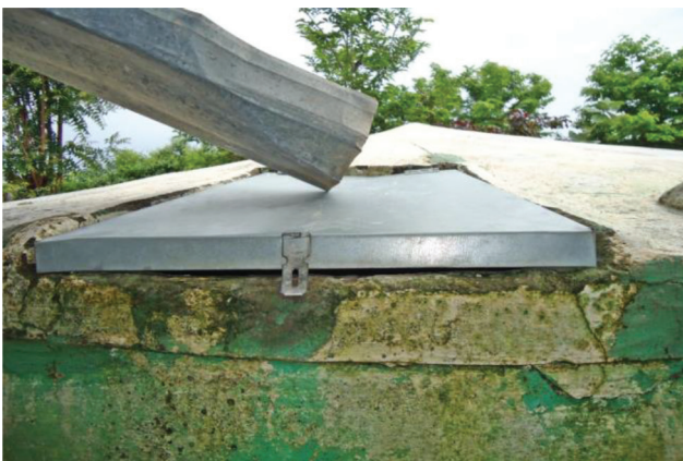
Figura 2. Cisterna precisando de pintura e reparos
