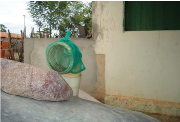
Figura 1. Tela de proteção usada no cano de entrada da água da chuva
