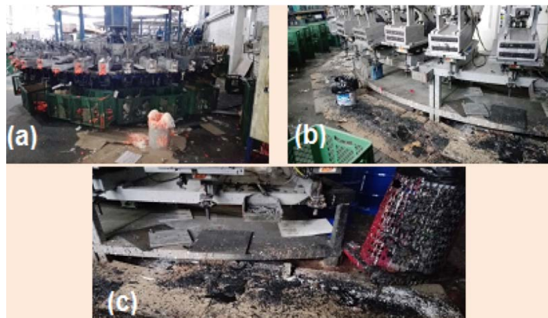
Figura 9. Orden y Aseo: (a) maquina inyectora de plantillas – Poliuretano derramado en el suelo y en recipientes plásticos sin tapar, (b) maquina inyectora de suelas – Poliuretano derramado en el suelo y en recipientes plásticos sin tapar y (c) maquina inyectora de suelas – Poliuretano derramado en el suelo y sobre cartón contaminando desechos reciclables.
