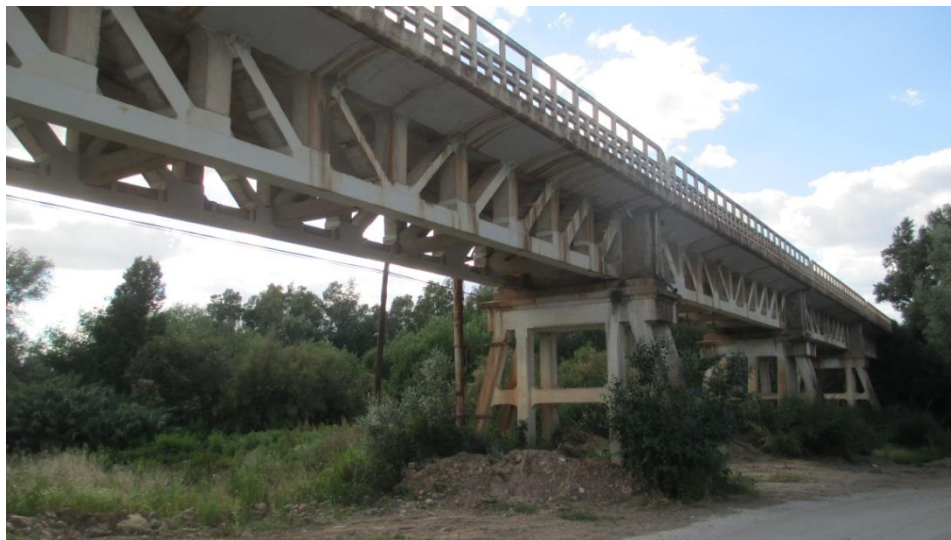
Puente sobre el Guadalquivir en la carretera de Villanueva de la Reina a Andújar. Antes de su construcción en 1920, en este mismo punto se situaría según la planimetría “los restos de un puente”. Foto M. Roll
