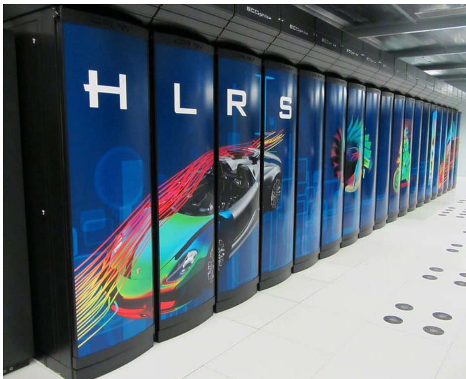
Figura 6: superordenador Cray XE6 del centro de cálculo de altas prestaciones de Stuttgart.
