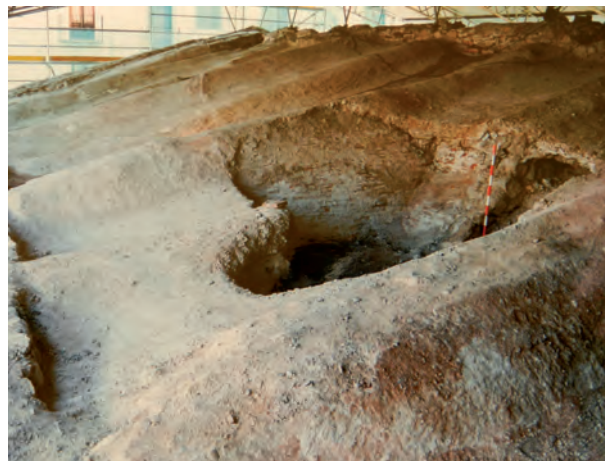
Figura 7. Detall d'alguns forats a la coberta produïts pels bombardejos contemporanis a l'edifici.
