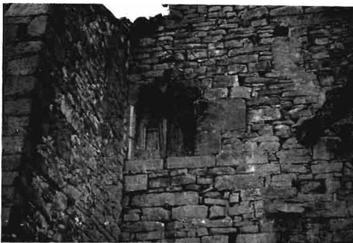
Ruinan en Nardués Aldunate. (Obsérvese la ventana sin cristales, con ventanillos.)
