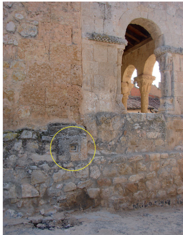
Ilustración n° 8. Ubicación de la pieza con loculus , embutida en la cimentación de la esquina suroeste de la nave
