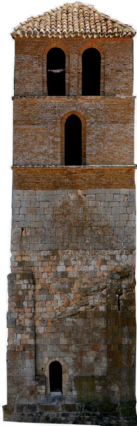
Ilustración nº 28. Ortofotografía del muro occidental de la torre, con el acceso abierto para acceder a la misma (realizada por la empresa Metria para el Proyecto Cultural Soria Románica)
