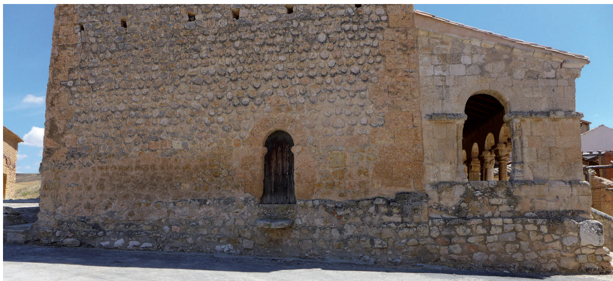
Ilustración nº 19. “Escalón” por debajo de la portada occidental antes de la intervención del entorno, donde resaltaba más su presencia por el descalce del terreno
