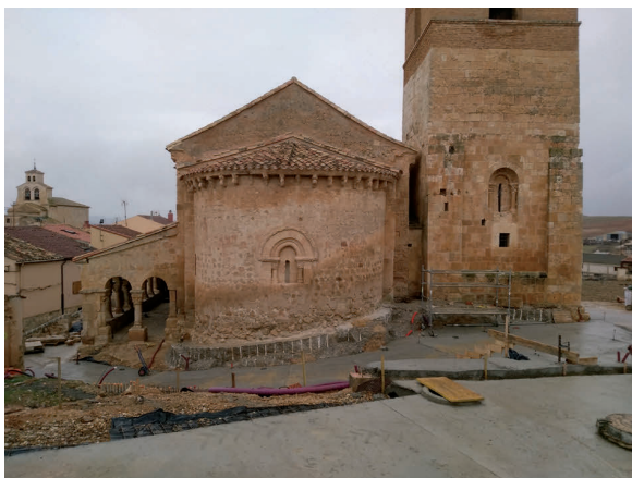
Ilustración nº 4. Obras de acondicionamiento en el entorno oriental del templo (febrero 2017). Se aprecia la relación entre torre y nave, adyacentes pero no adosadas
