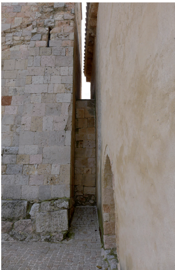
Ilustración nº 29. Separación entre torre y muro norte de la nave (año 2020)
