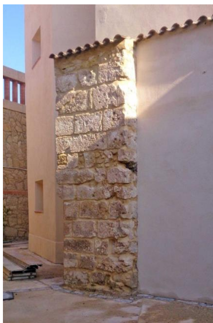
6. Estructura de sillería en la zona de la cabecera de la iglesia, 5 de abril de 2017. Fotografía Antonio Bravo.
