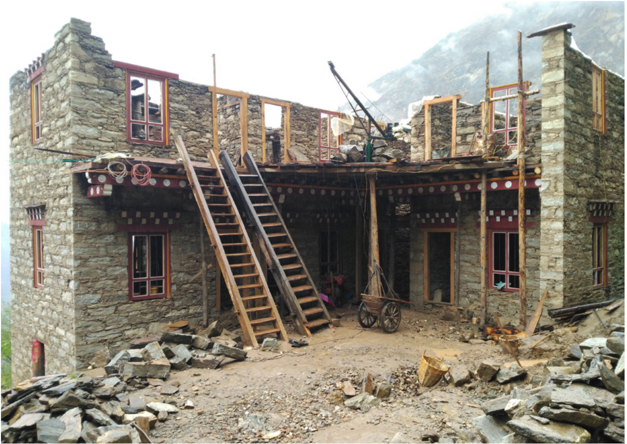
Traditional house in construction in Chonglu, Sichuan, 2018 | Casa tradicional en construcción en Chonglu, Sichuan, 2018 | Casa tradicional em construção em Chonglu, Sichuan, 2018
