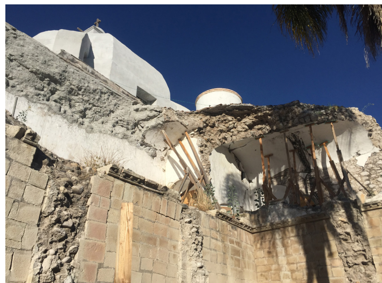
Figura 7. Reparaciones realizadas décadas atrás con materiales incompatibles que incidieron en el colapso de las bóvedas del convento del siglo XVI tras el terremoto del 2017, Jantetelco, Morelos (L. F. Guerrero)
