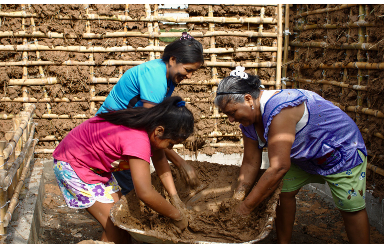
Figura 2. Participación de las mujeres de la comunidad en la construcción, Ixtepec, Oaxaca (Cooperación Comunitaria)
