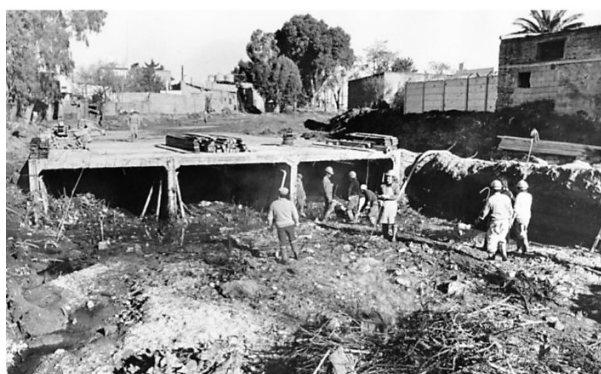
Primera etapa de la realización del entubado del arroyo en calles Brown y Estados Unidos (1978)
