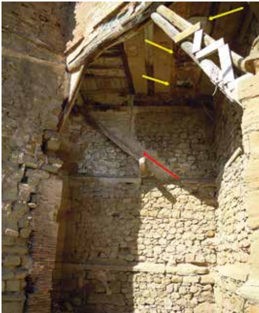
Figura 12. Espacio bajo las letrinas de la iglesia. Las flechas amarillas marcan los agujeros en el forjado y la roja, la huella de la línea de escalones. Foto: Ana J. Mateos.
