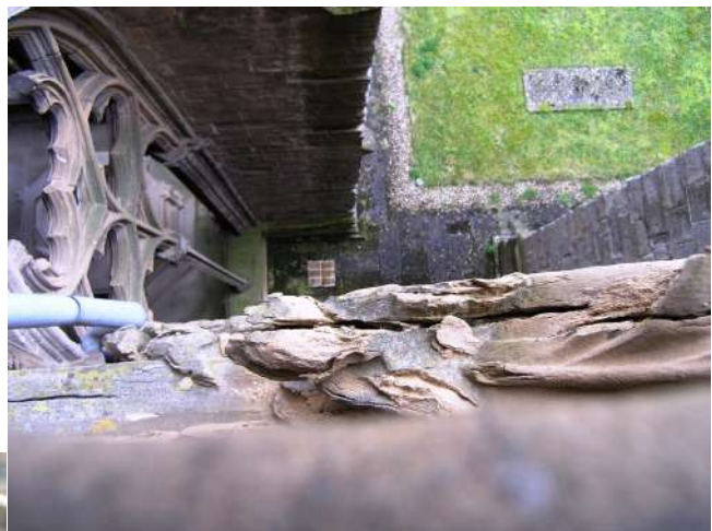
Foto 2. En los alzados exteriores muchas zonas presentaban un alto riesgo de desprendimientos por las fracturas de la piedra. Fotografía Gobierno de Navarra.
