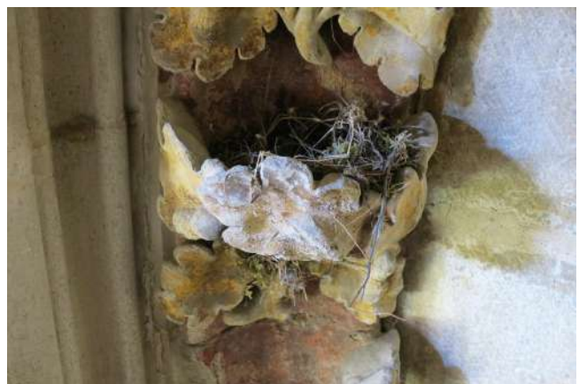
Foto 6. La presencia de aves en el claustro es una de las causas de deterioro. (Fotografía cedida: Sagarte, S.L.)
