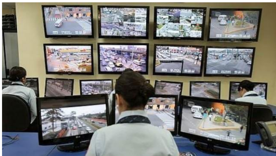
FIGURA 5 | Centro de Control y Vigilancia C4 en Cabo San Lucas
