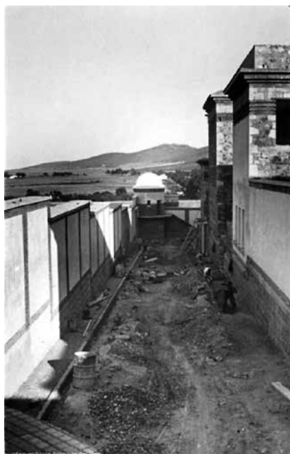
Obras en la nueva prisión provincial de Cáceres, 1 de junio de 1936 (3). Archivo de la Ciudad de Arganda del Rey, Fondo: Arquitectos Aranguren.
