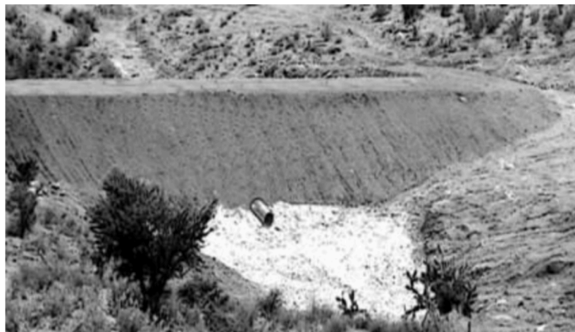
Figura 4. Tubería de desagüe. Fuente: [16].
