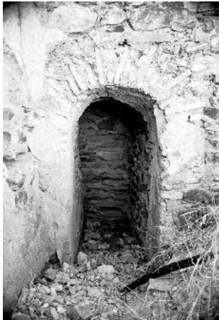
Aspecto de la poterna de la cortina oeste antes de las obras.
