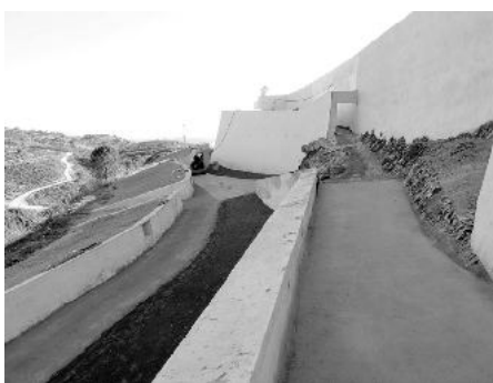
Acceso al "tambor" que protege la entrada norte al fuerte, durante las obras.
