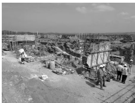
Habitaciones del gobernador, polvorin, capilla y sacristía vistos desde el sureste, al inicio de las obras.
