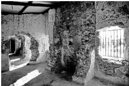
Cuerpo de guardia del cuartel de la tropa, con restos de la chimenea. Se observa el expolio de los ladrillos con los que estaban ejecutadas las moquetas.
