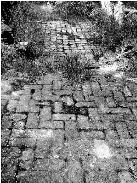
Pavimento de ladrillo en la capilla (fondo) y zona de acceso (primer plano).
