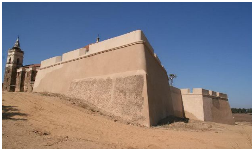
9.3 Imagen general del baluarte de levante tras la restauración. Fuente: Antonio López Domínguez. Consejería de Educación, Cultura y Deporte.
