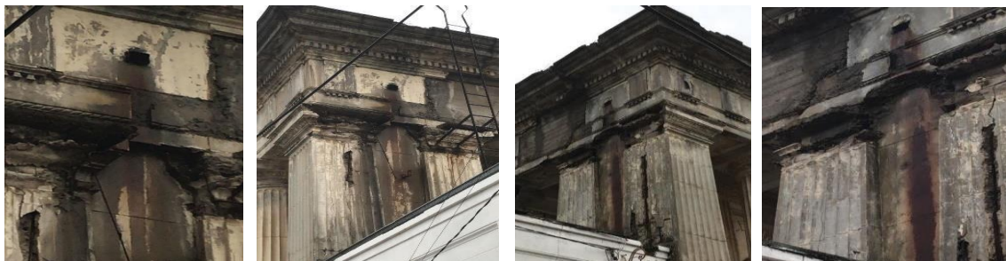
Figuras 15, 16, 17 y 18: Imágenes de bajada de aguas en el Pórtico
