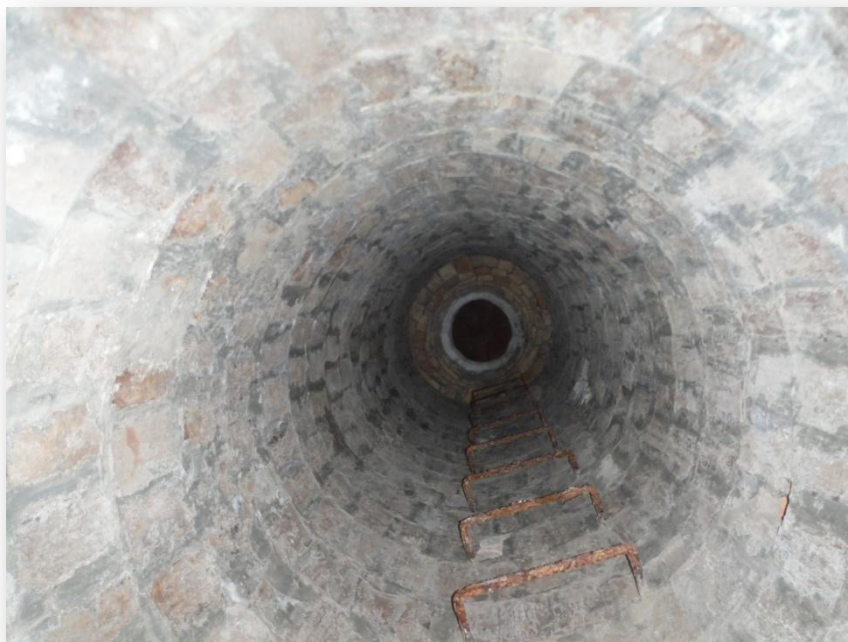
Fig. 11: Vista desde el interior de la galería de uno de los pozos de registro Foto: Archivo G40
