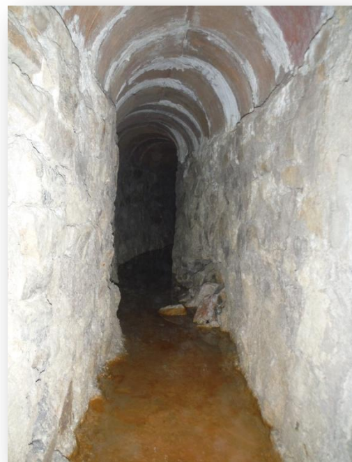
Fig. 7: Fragmento de galería donde se aprecia la rotura del muro por empujes verticales. Foto: Archivo G40
