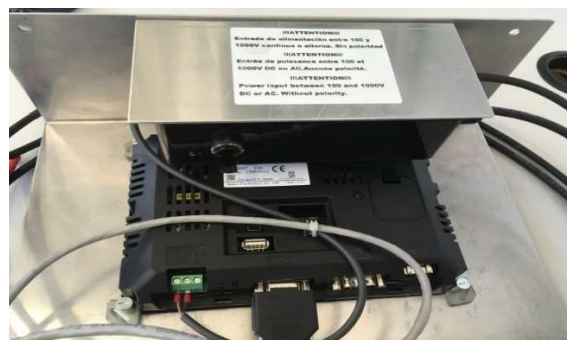
Fig. 5. Imagen de la parte trasera de la interfaz que monitoriza y configura el variador de velocidad donde se observa la propia interfaz (parte inferior) y la fuente de alimentación (parte superior).
