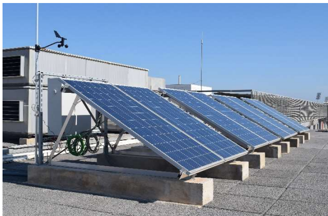
Fig. 1. Vista del campo fotovoltaico, se puede ver el cuadro eléctrico en la parte posterior del campo fotovoltaico.
