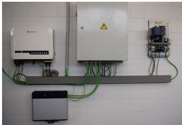
Fig. 2. Componentes de la instalación montados en el laboratorio.
