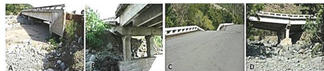
Figura 17. Afectaciones estructurales en puentes de la carretera Granma por efecto de erosión por socavación en los ríos que la atraviesan (Caoba, Sevilla, La Plata, entre otros de la vertiente sur).
