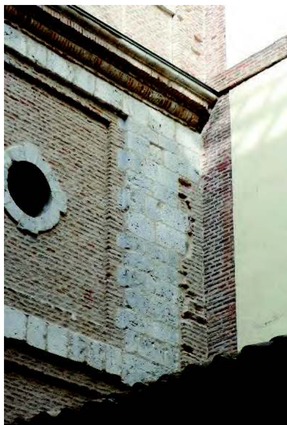
Figura 9. Unión entre la torre actual y el crucero de la iglesia de San Andrés. Se observa la rotura del muro antiguo –producido seguramente al desmontar la torre antigua– al que se adosa la nueva. Probablemente esta parte es el pilar que para apoyar la torre anterior se hizo en 1706.
