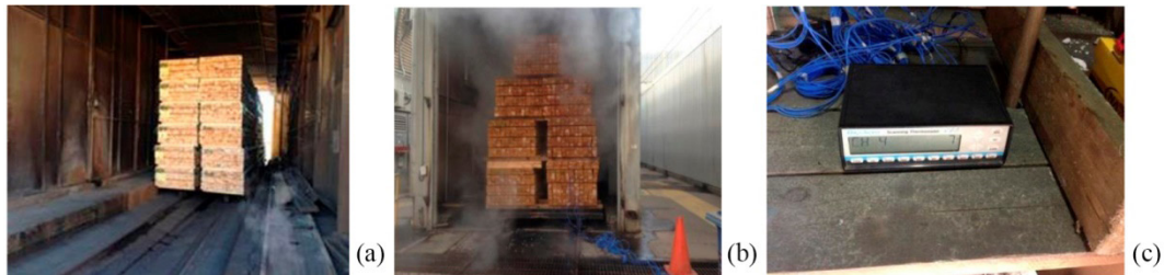
Figura 5: Instalaciones e instrumental para tratamientos industriales con vapor. (a) Horno secado certificado, (b) Cámara de vaporizado, (c) Sistema adquisición datos.
