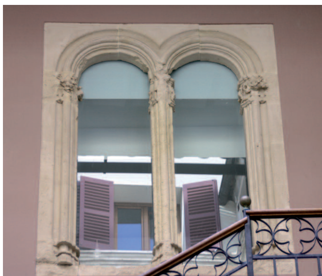
Fig. 2. Palma de Mallorca. Ventana geminada de Can Gradolí (foto de HAR2016-77032-P, MINECO/AEI/FEDER, UE).
