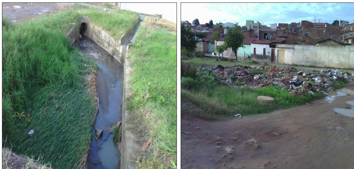
Figuras 8 e 9. Canal de esgoto e acúmulo de lixo no Parque Municipal Lagoa das Bateias Fonte: Trabalho de Campo. Foto: SANTOS, M. F (2017).
