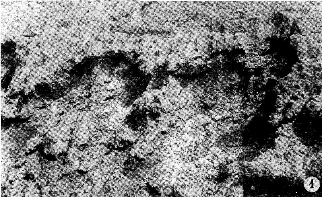
Foto 1.- Eflorescencias sobre lutitas con desarrollo de pequeños nichos. Se aprecia un control tanto estructural como textural, correspondiendo la situación de las eflorescencias a capas más permeables.
